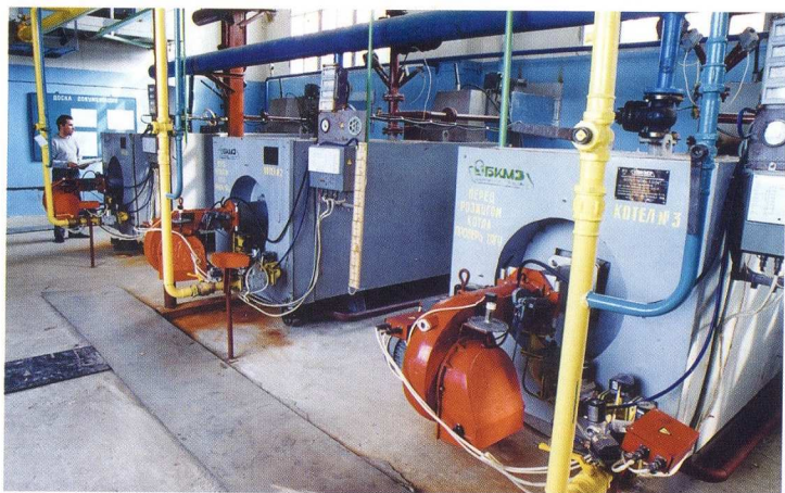
Котельная. Введена в эксплуатацию в 2003 г.
